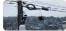
시설물 파손 낙하 위험
