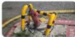
소화 시설 파손
