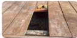
행사장 시설 파손
